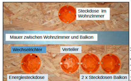
Bild 3: Testtafel zur Veranschaulichung der Verkabelung bei der Montage einer Verteilerdose auf einem Balkon. Von dort aus wird die Energiesteckdose für den Wechselrichter angeschlossen
