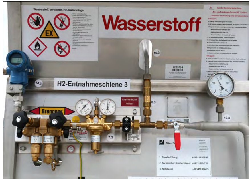
Bild 3: Schalttafel an der LKW-Dockingstation
