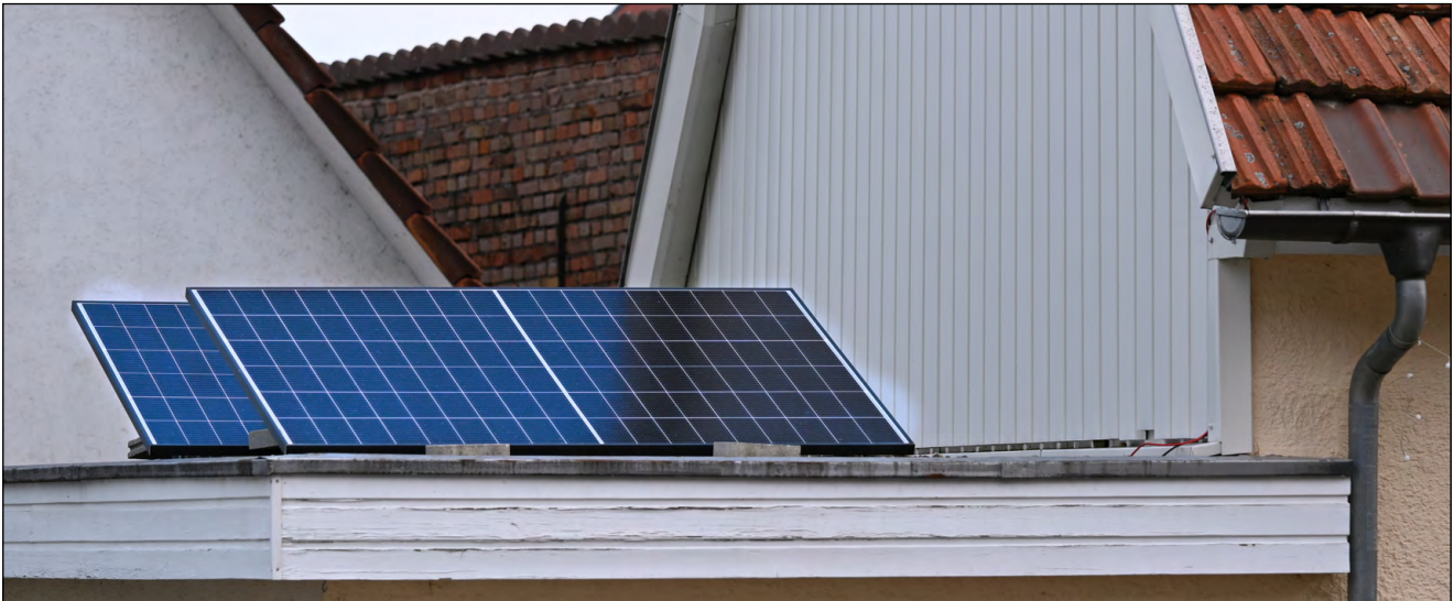
Bild 2: Nach einem Gesetzentwurf des Justizministeriums sollen Mieterinnen und Mieter zukünftig einen Anspruch auf die Installation und Nutzung eines Steckersolargerätes haben
