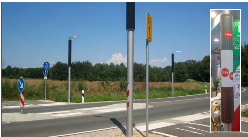
Bild 8: Zylindrische Solarmodule an Masten von Laternen versorgen diese an einer Wegkreuzung mit netzunabhängigem Solarstrom
