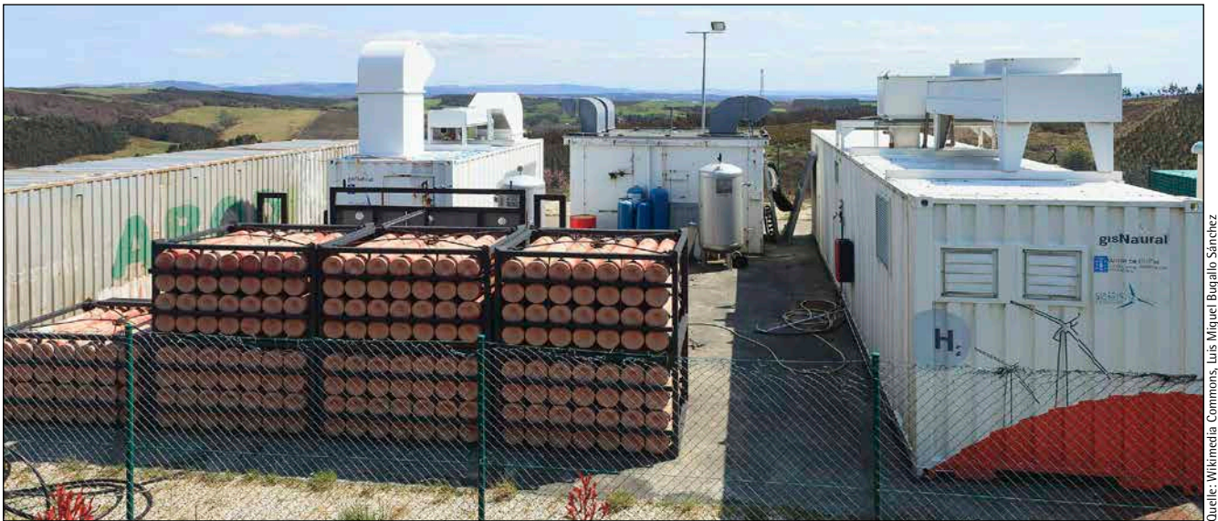
Bild 2: Demonstrations-Power-to-Gas-Anlage in einem spanischen Windpark
