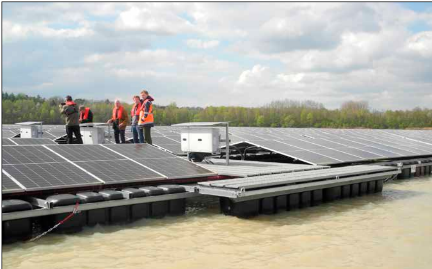
Bild 1: Besichtigung der Floating-PV-Anlage mit 3,1 MWp in Haltern
