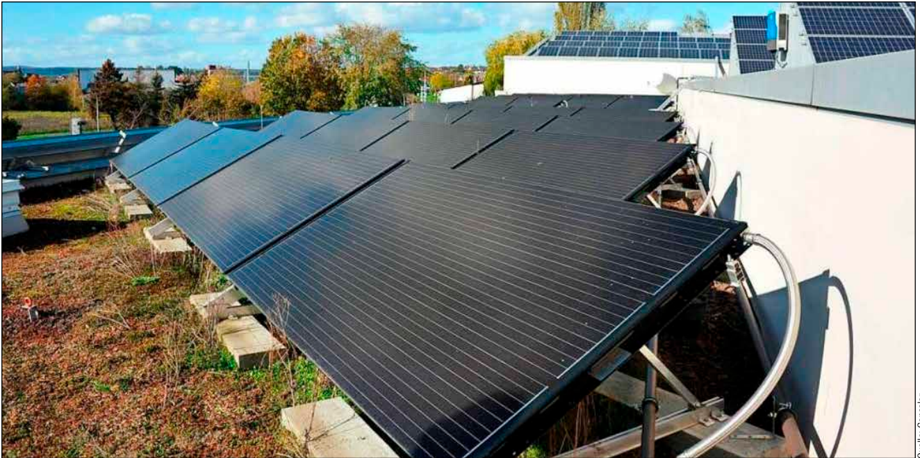
Bild 1: Hybridanlage mit PVT-Kollektoren liefert Strom und Wärme
