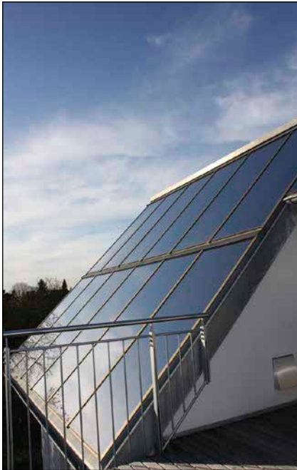
Bild 1: Flachkollektoren auf einem Hausdach in München
