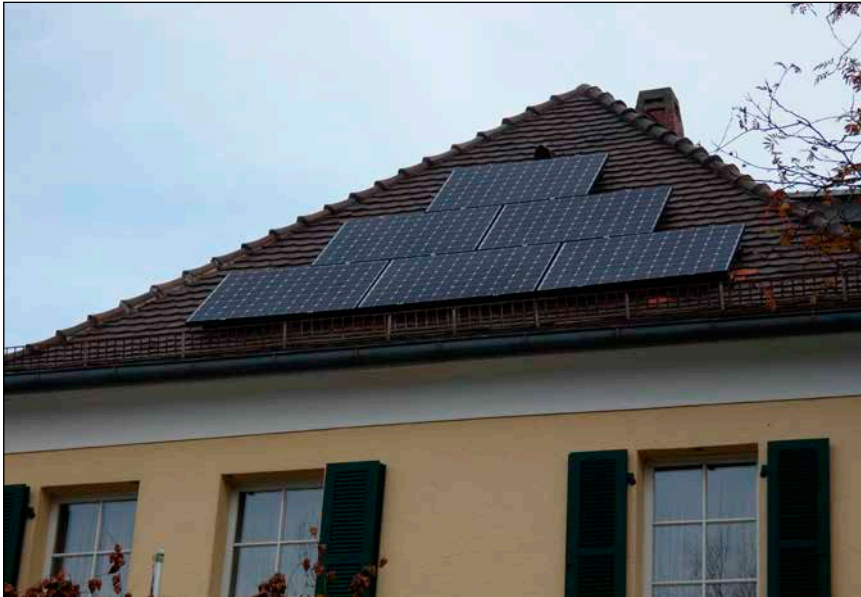
Bild 1: PV-Hausanlage in Ettlingen bei Karlsruhe.
