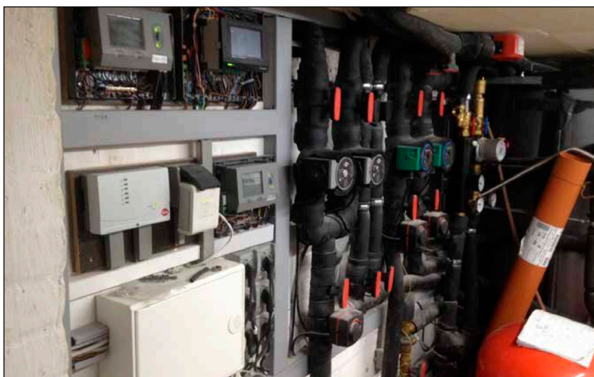
Bild 4: Technikraum mit Steuergeräten und Heizungsverteilung
