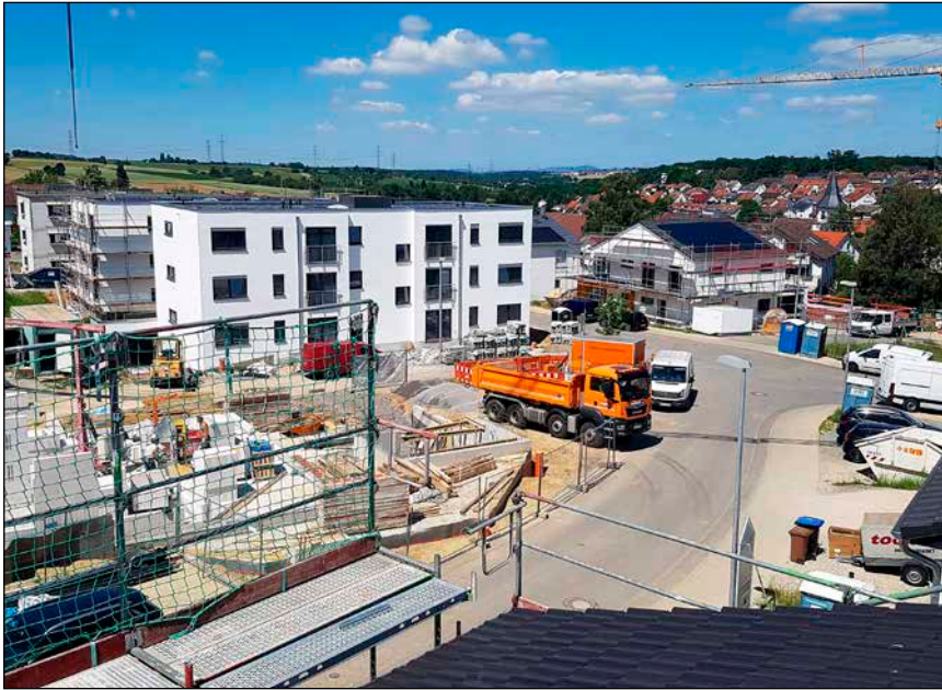
Bild 1: In diesem Neubaugebiet in Waiblingen werden alle Dächer mit PV-Anlagen ausgestattet.
