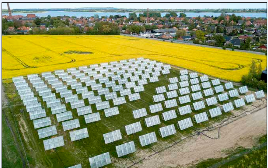
Bild 5: Heliac Solaranlage in Lendemarke (Dänemark)
