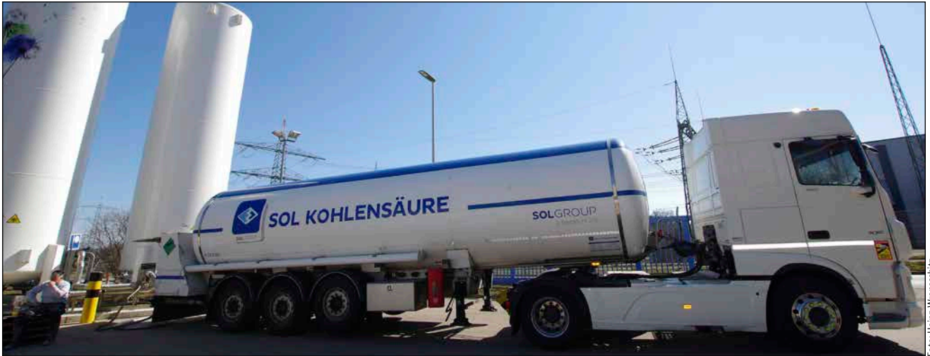
Bild 1: Lkw-Befüllanlage, links die CO 2 -Speicher.
