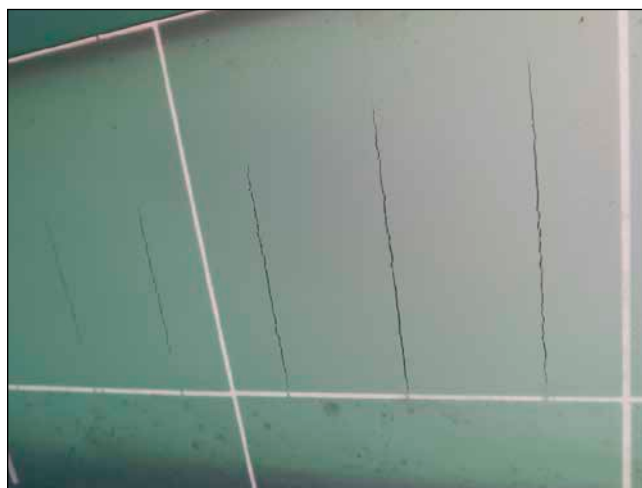
Bild 4: Das Bild zeigt Risse in der Rückseitenfolie über den rückseitigen Zellkontakten von Solarmodulen.
