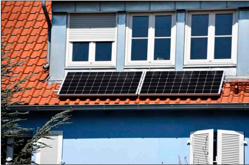
Bild 1: Zwei Solarmodule unter einer Dachgaube in Baden-Württemberg
