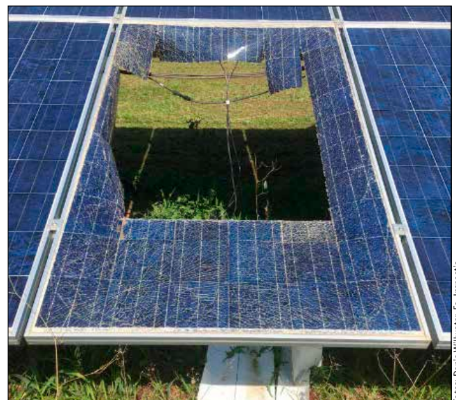
Bild 2: Am Ende kommt es zum vollständigen Zusammenbruch der Module
