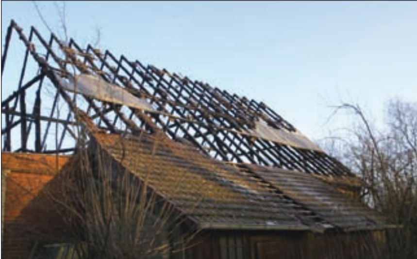
Bild 1: Feuer zerstört PV-Anlage
