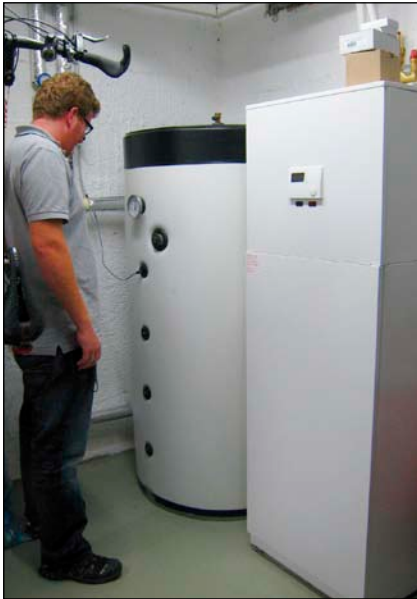
Erdsonden-Wärmepumpe und Warmwasserspeicher
