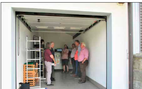
Tag des Offenen Stromspeichers 2018
