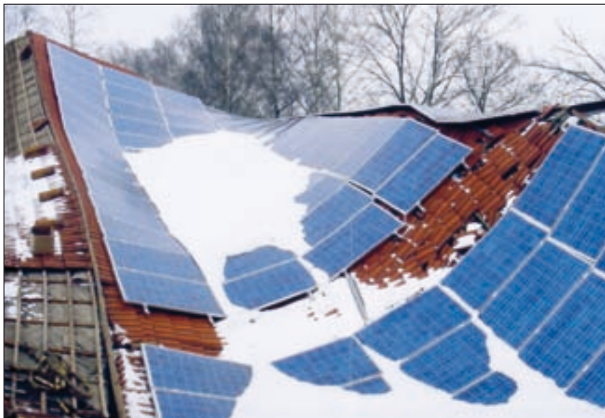
Durch Schneedruck beschädigte Photovoltaikanlage
