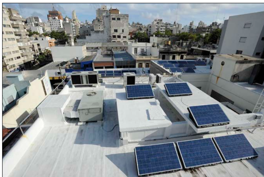
Bild 5: Photovoltaikanlage auf dem Bayer Buerogebäude in Montevideo
