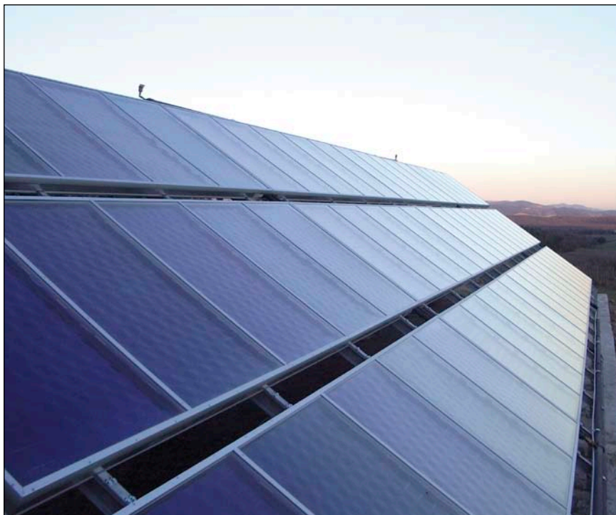
Bild 1: Aufgeständerte Solarthermie-Anlage auf einem Hotel
