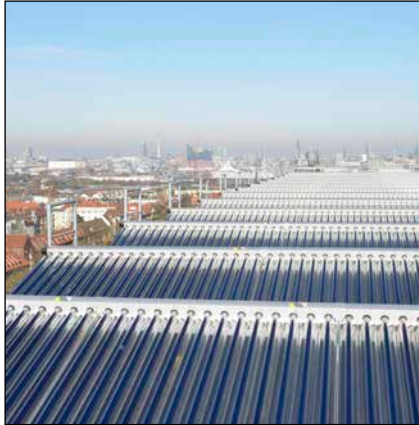
Thermische Solaranlage im Wärmenetz von Hamburg-Wilhelmsburg
