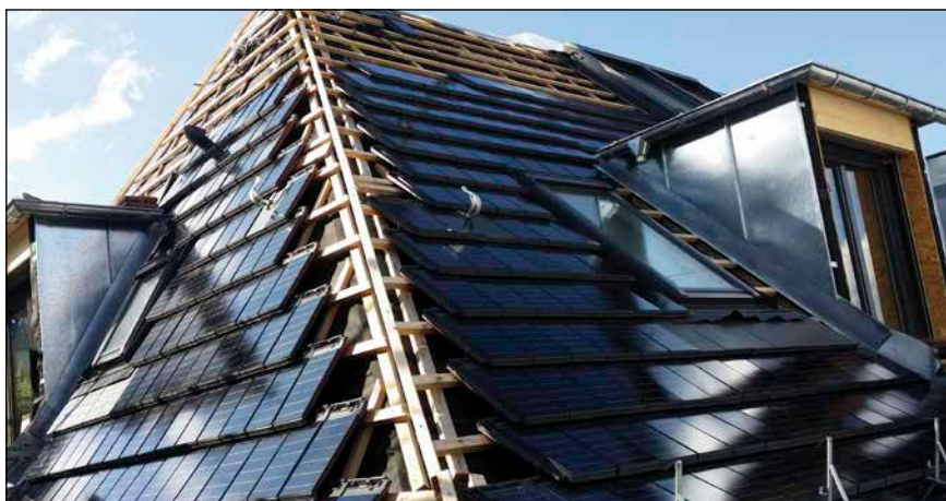
Bild 3: Solarsystem mit integriertem Dachfenster und Kamin
