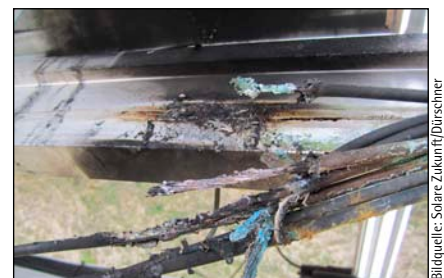
Bild 2: Durch Steckerbrand zerstörte benachbarte DC-Leitungen
