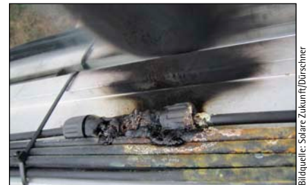
Bild 1: Brand durch mangelhaft konfektionierte Steckverbinder
