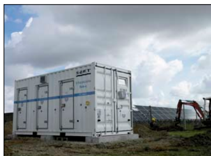
Bild 2: Batteriemodul im Container auf dem SmartRegion Gelände
