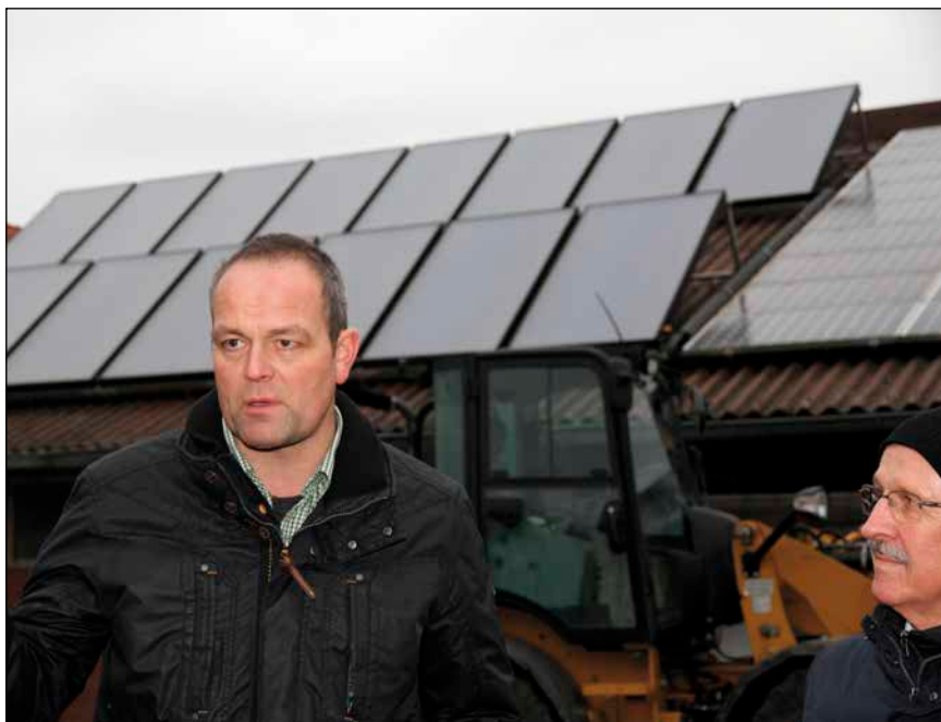
Die Solarthermieranlage, 40 m 2 , auf dem Kuhstalldach. Rechts daneben die PV-Anlage, die Sonnenstrom ins Netz speist.
