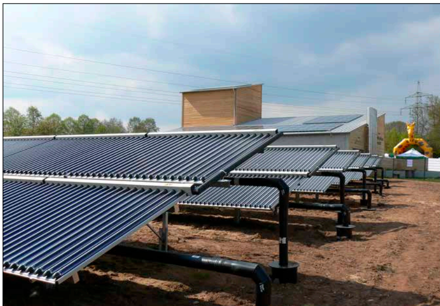
1.300 Quadratmeter Kollektorfläche ergeben Bayerns größte Solarwärmanlage
