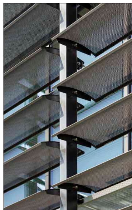
Bild 2: Semitransparenter Lamellen-Vorhang als Wärmeschild an der Ostfassade
