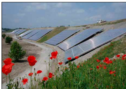
Solare Nahwärme Craisheim
