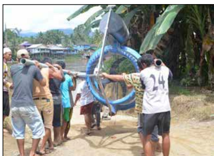
Bild 6: Installation einer Smart-Mono-float-Turbine in Indonesien
