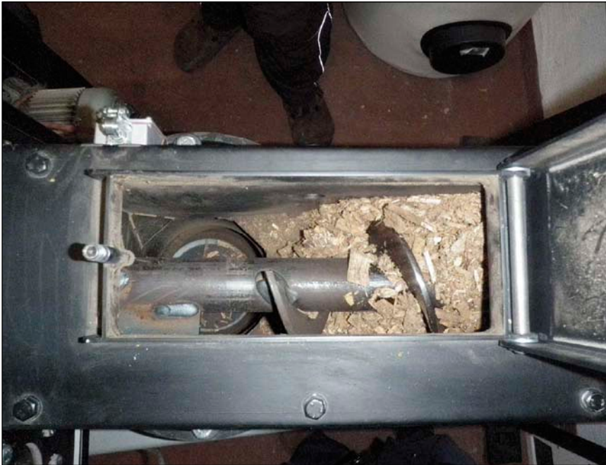
Bild 1: Rückbrandsichere Zuführung der Hackschnitzel zum Kessel
