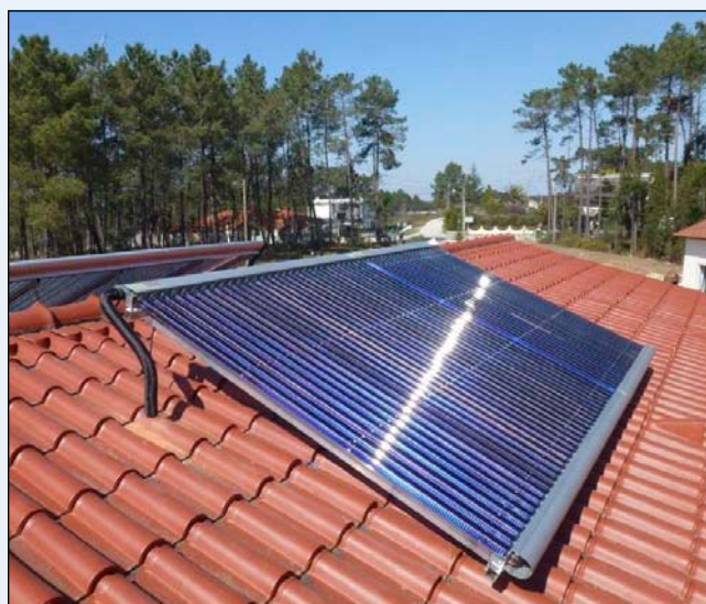
Bild 3: Akotec-Anlage mit eigensicheren Narva Heatpipe-Vakuumröhren in Portugal
