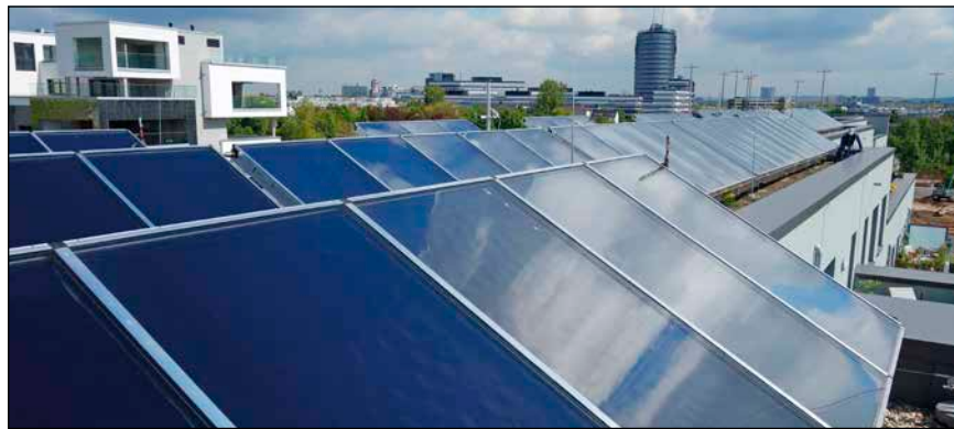
Bild 2: Kollektorfeld der SWD.SOL-Pilotanlage in Düsseldorf
