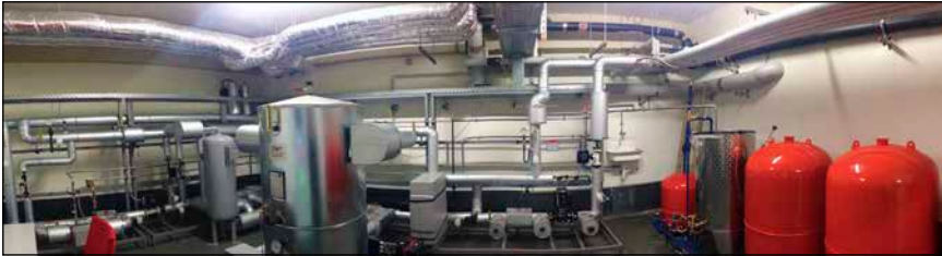
Bild 1: Einspeisestation der SWD.SOL-Pilotanlage in Düsseldorf
