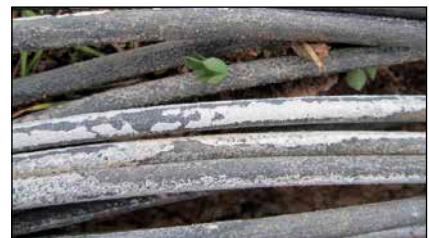
Bild 7: Im Erdreich verlegte, mangelhafte Stringleitungen
