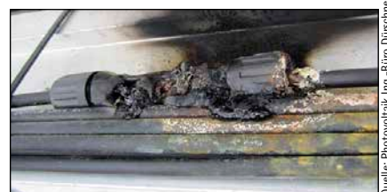
Bild 6: Abgebrannte Steckverbindung (Kreuzverbund)
