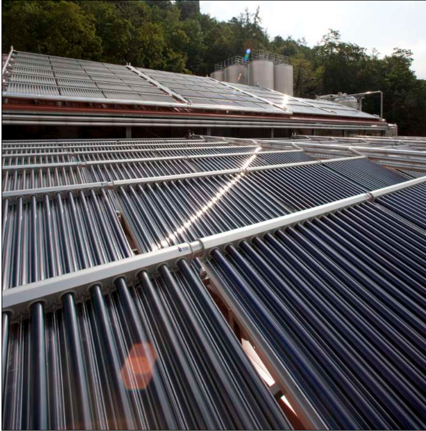
Bild 1: Konzentrierende Vakuumröhrenkollektoren zur Unterstützung der Brauprozesse
