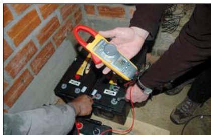
Bild 2: Installation der Batterien und Demonstration der Spannungsmessung
