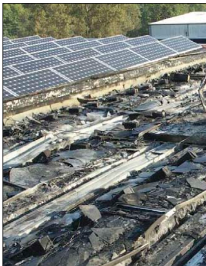
Brand einer PV-Anlage auf einem Flachdach. Der Gutachter fand Modulreste, die schlechte Lötverbindungen als Ursache sehr wahrscheinlich machen
