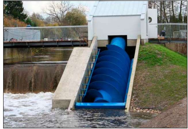
Bild 9: Wasserkraftschnecken können bereits bei niedrigen Fallhöhen betrieben werden. Hier ist eine 49,1-kW-Anlage aus Krechting im Kreis Borken zu sehen.
