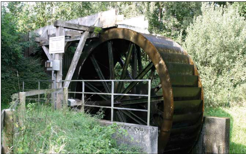
Bild 1: Wasserrad am Auslauf der Kläranlage Warendorf
