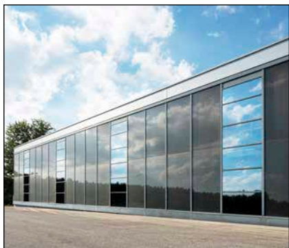
Bild 1: P/R-Fassade mit integrierten thermischen Kollektoren
