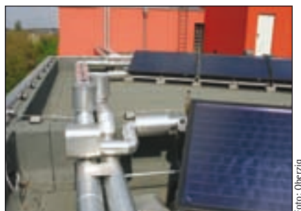
Bild 5: Solardach in der Swinemünder Straße, Berlin (DEGEWO)
