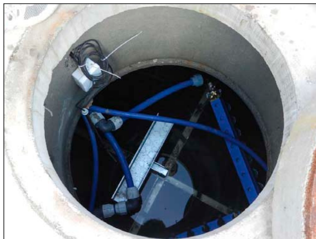
Bild 2: Das innere des SolarEis Speichers
