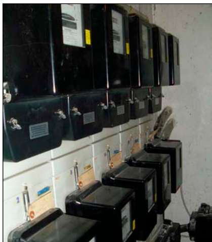
Bild 1: Klassische Zähleranlage eines Mehrfamilienhauses
