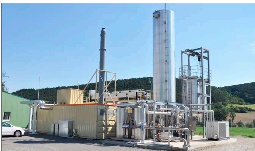
Bild 1: Gasaufbereitungsanlage, die Biogas zu Biomethan „veredelt“
