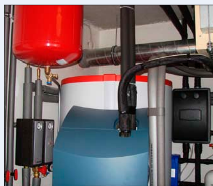
Bild 4: Erd- und Abluftwärmepumpe mit kleiner Energiezentrale.
