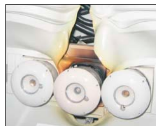
Bild 11: Dieser Sicherungssatz ist sehr heiß geworden. Am Kontakt zur Fassung trat ein hoher Übergangswiderstand auf.
