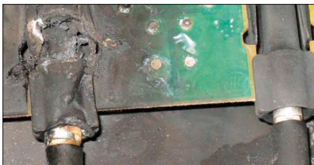
Bild 9: beschädigter Steckkontakt in einer Modulanschlussdose
