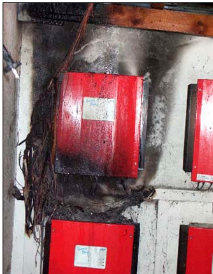
Bild 12: Verbrannte Leitungen an einem Wechselrichter.
