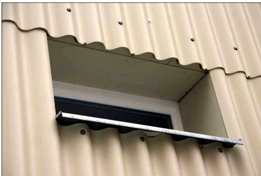
Bild 2: Dämmwahn und kein Gedanke an die Bewohner: das Badezimmerfenster wird zum Lüftungsschlitze degradiert.
