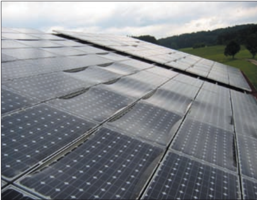
Schneedruckschäden an einem Photovoltaik-Modulfeld
