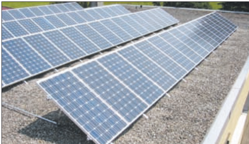
Photovoltaikanlage mit Randabstand zur Vermeidung zusätzlicher Windlasten
