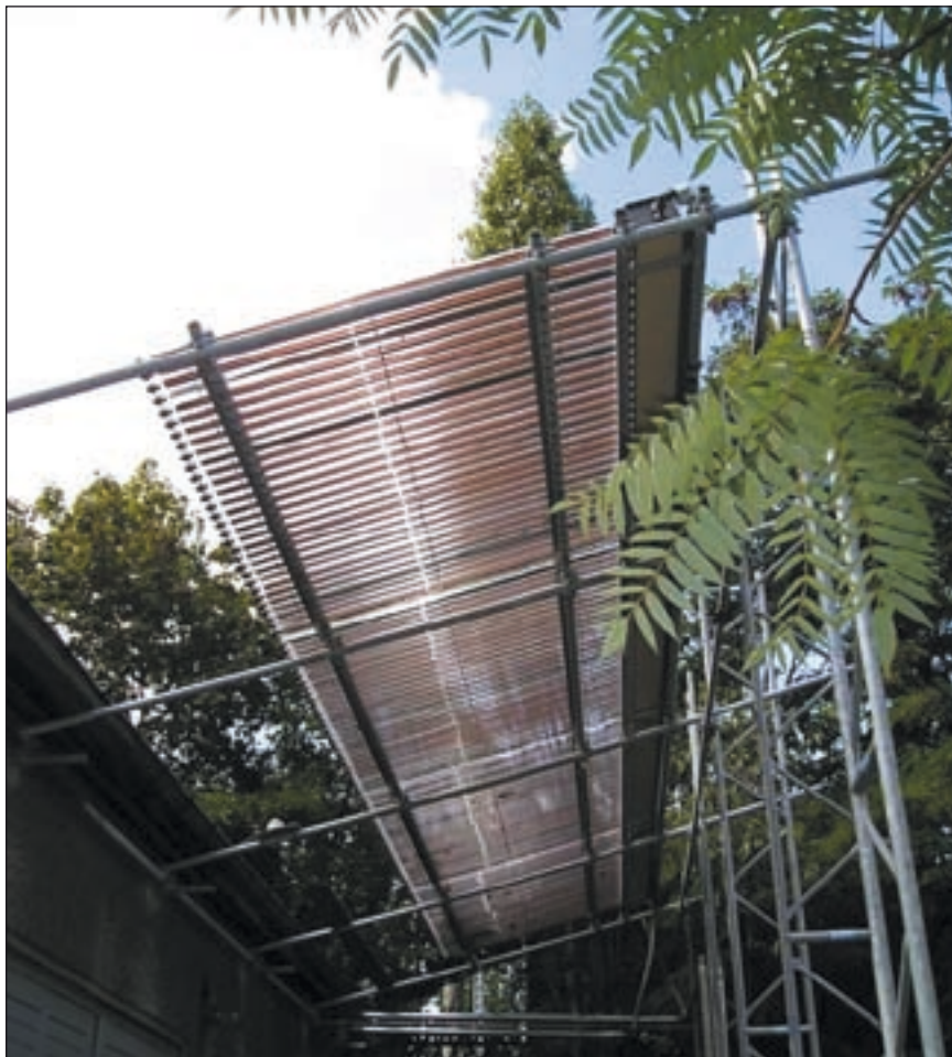
Bild 3: Spezielle Vakuumröhrenkollektoranlage zur Einspeisung eines Langzeitspeichers
