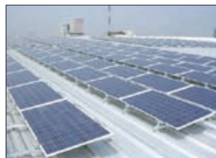
Bild 6: Solarmodule auf einem TESCO Supermarkt
