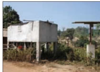
Bild 7: Wasserbehälter mit PV betriebener Distributionspumpe
