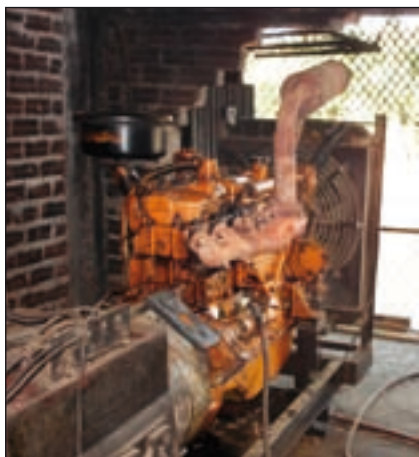
Bild 3: Generator für ein kleines Netz in Kambodscha
