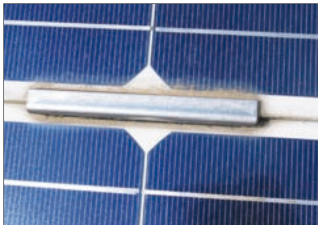
Bild 2: Verschmutzung von Modulen (nach 10 Jahren Anlagenbetrieb)
