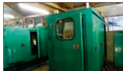
Blick auf die Generatoren
