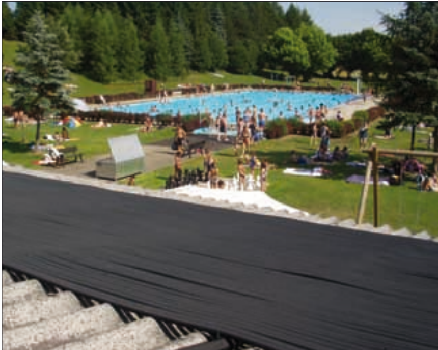
Bild 1: Freibad mit Absorberanlage
