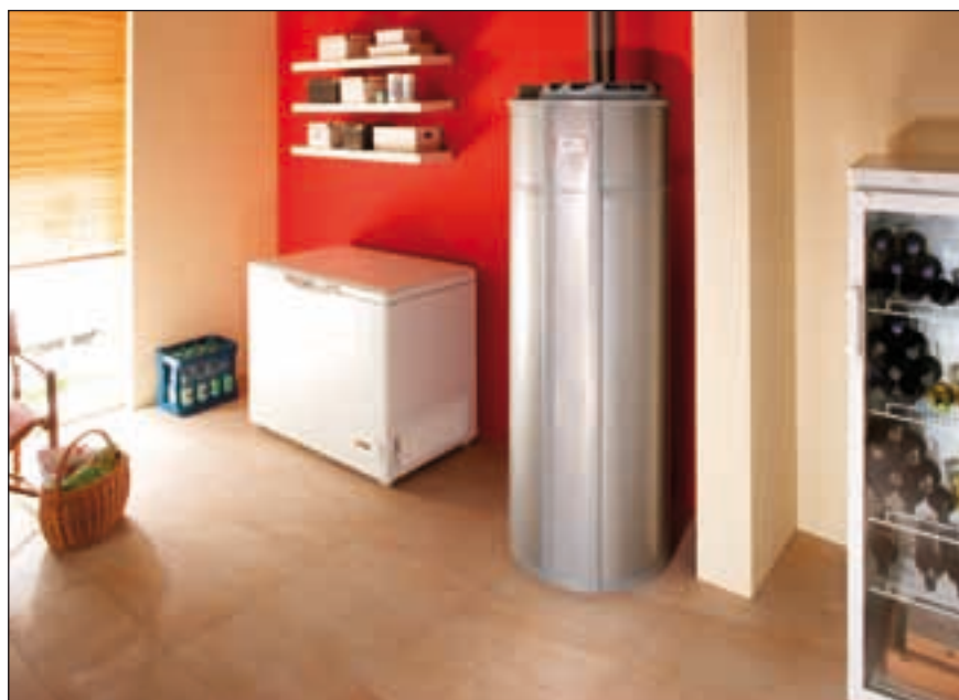
Bild1: Wärmepumpe im Kellerbereich
