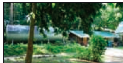
Generatorhaus und 30.000 Liter Dieseltank des Resorts
