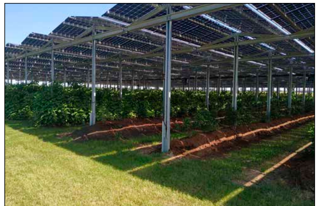
Bild 3: 750 kWp auf 4.200 m 2 Anbaufläche – NRW's größte Agri-PV-Anlage
