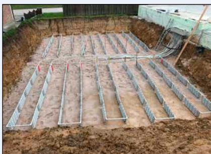
Bild 4: So sieht die Anlage für ein neues Einfamilienhaus mit 10 kW Entzugsleistung aus. Später ist davon nichts mehr zu sehen.
