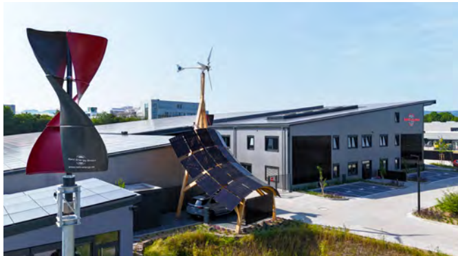
Andernach Die Firma Rehl Energy GmbH betreibt neben PV-Anlagen auch eine LS Helix Turbine
