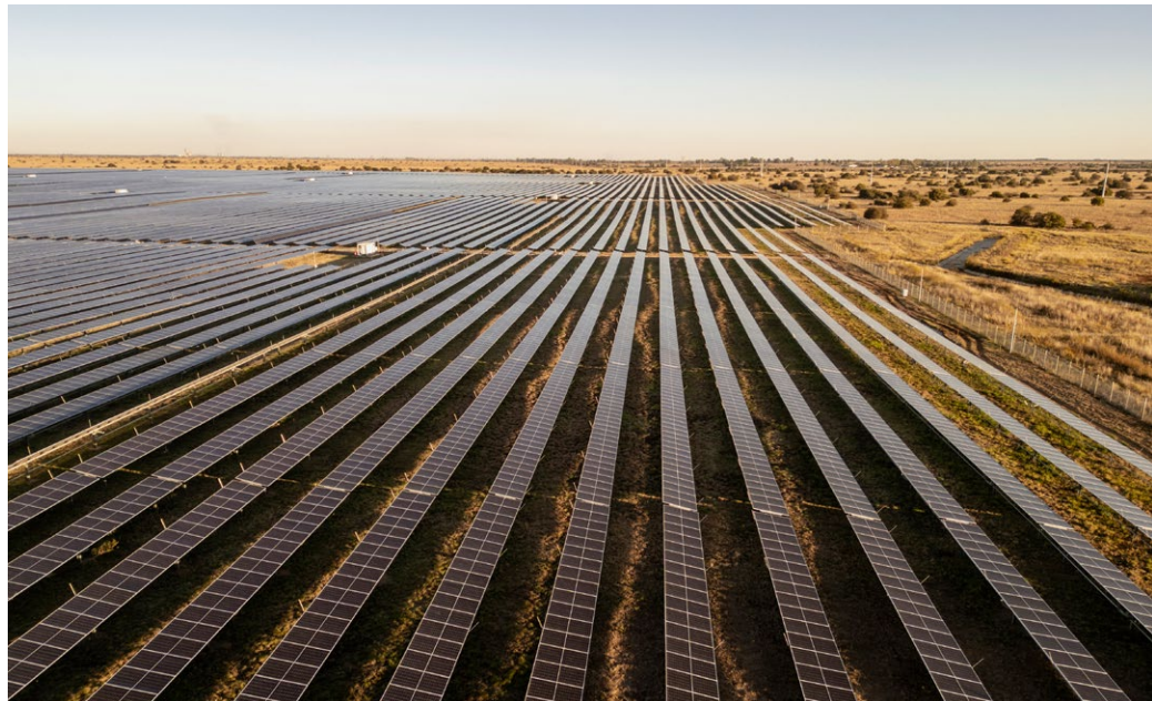
Luftbild Selemela-Solarpark in der Provinz Nordwest (Südafrika)
