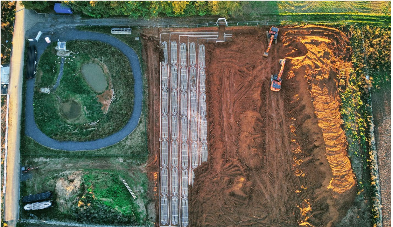
Luftbild Erdwärmekollektoren für ein kaltes Nahwärmenetz
