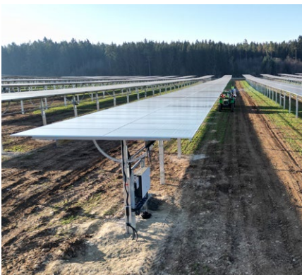
Solarpark Agri-PV-Anlage in Veringenstadt (Baden-Württemberg). Das Solarprojekt umfasst Trackersysteme in zwei Ausrichtungen mit insgesamt 8,5 MW p
